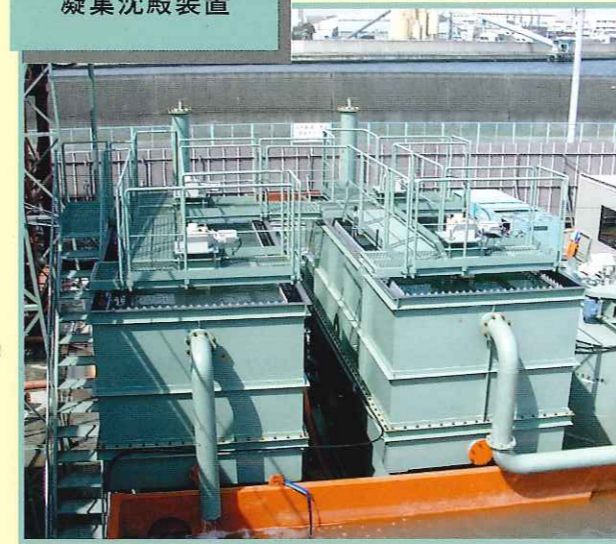
凝集沈殿装置
